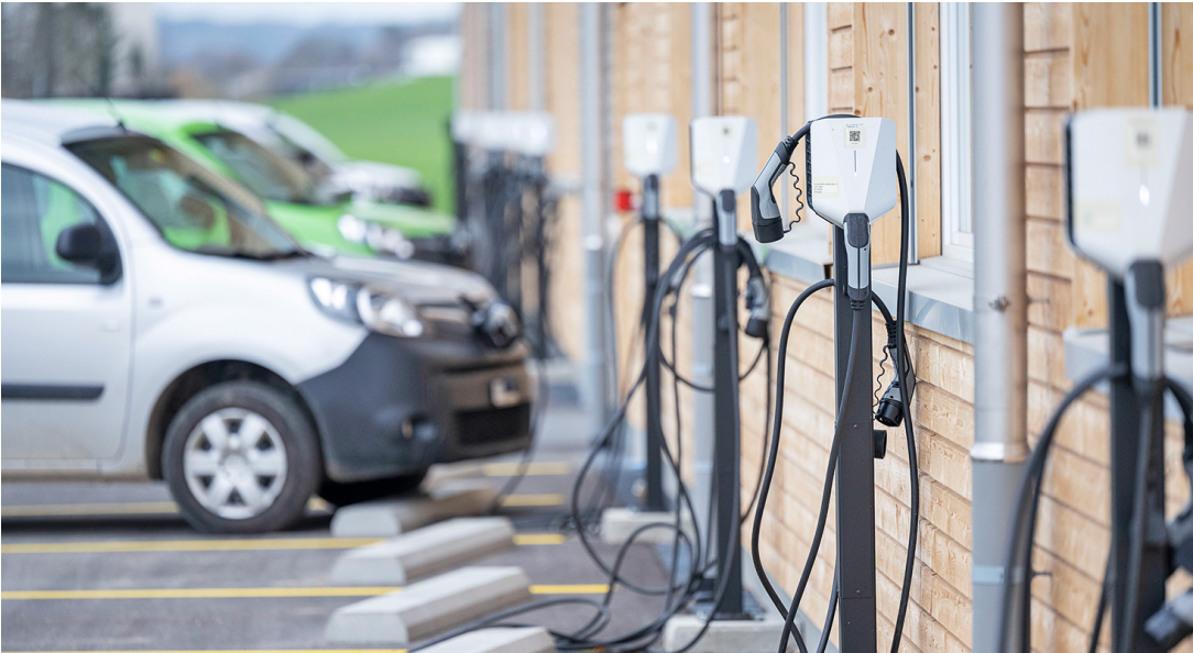
Für die volle Ladung der Batterie braucht es meist nicht mehr als 30 Minuten.
